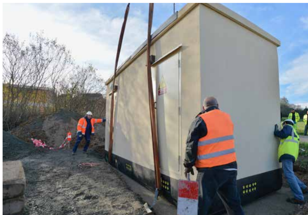
Installation du NRO (Noeud de Raccordement Optique) à Hautefort
