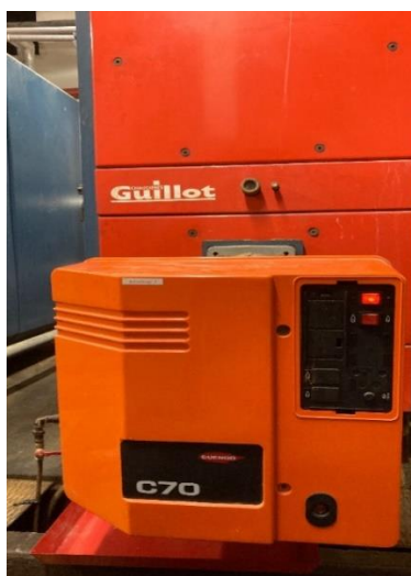
Figure 1 : chaudières fioul GUILLOT - Source : CDC Conseil
