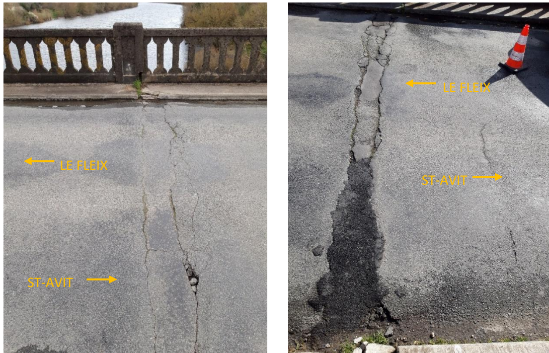
Figure 4 : Etat de la chaussée au droit des dallettes [Photos DIADES]
