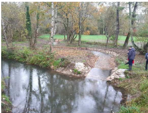
Travaux de création d'un bras de contournement sur le cours d'eau de la Belle en amont du Moulin de Lespinasse à Mareuil-en-Périgord réalisés par le SRB Dronne
