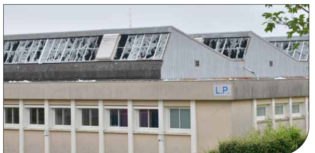
Toiture du Lycée Professionnel de Ribérac, détruite par la grêle.
