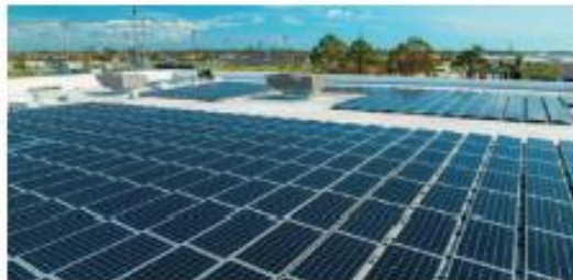
Les panneaux solaires installés sur les toits des bâtiments publics de la commune de Villeneuve-d'Ornon. Photo: groupe SGE
