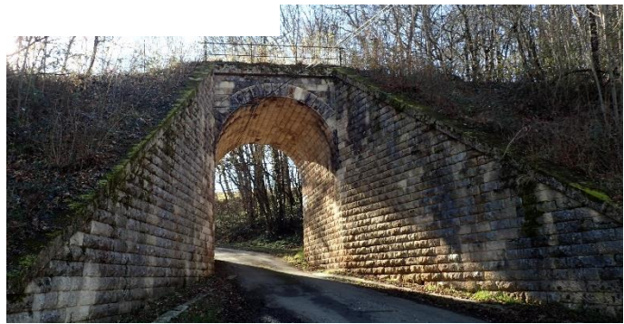
Tunnel en pierre de voie ferrée, ici près du bourg d'Eyzerac (BKM Environnement, 2022)
