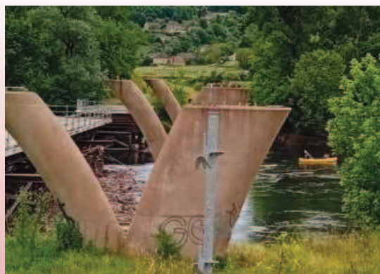
Pech rive droite : présence d'embâcles
