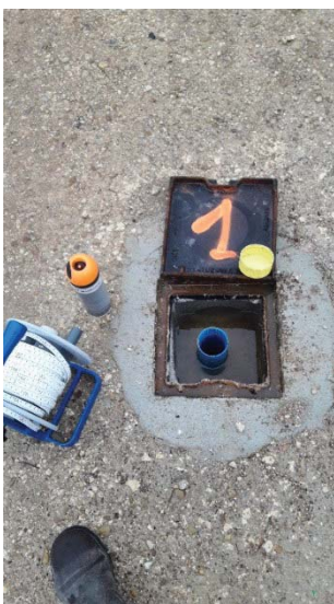
Barrage du grand étang de Gurson – Piézomètre n°1
