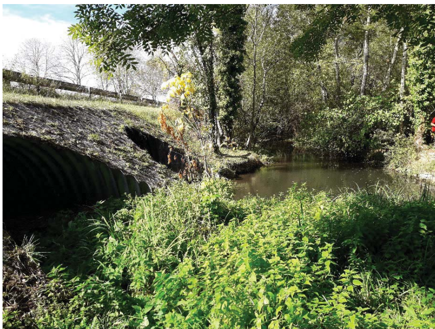
Ouvrage d'art départemental (D939) à restaurer sur la Belle à Mareuil
