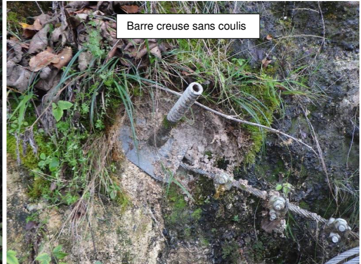
Manchon de liaison cassé et tension excessive au coin du filet
