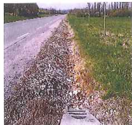
Photos 5 et 6 Les dégâts de l'herbicide : c'est du passé Herbicide damage: a thing of the past
